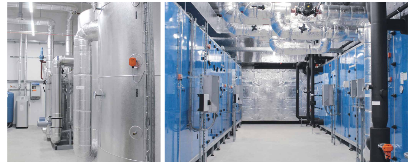
Imposante Technikzentralen im 2. Untergeschoss
