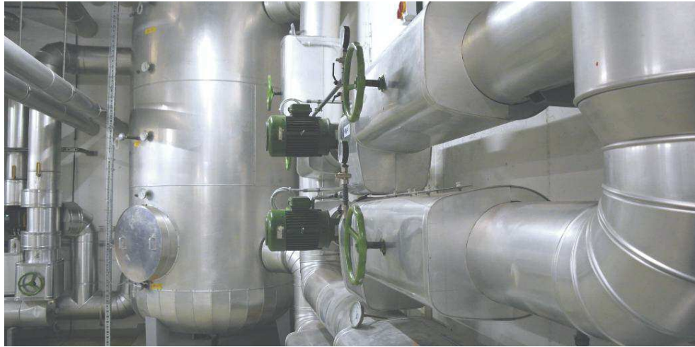
Der Wärmespeicher hält stets wertvolle Heizwärme für das Spital bereit. Zusätzlich dient er zur hydraulischen Entkopplung der Maschinen und dem Wärmenetz, wodurch ein stabiler Anlagebetrieb möglich wird.
